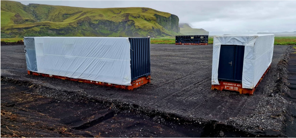
MYND 3.6 Vinnslusvæðið við Uxafótarlæk. Fagradalshamar sést í bakgrunninum. Mynd tekin á framkvæmdatíma þegar verið var að koma fyrir búnaði á lóðinni.
